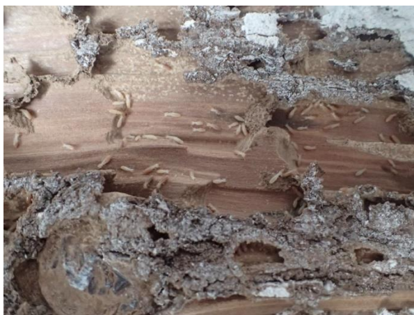
Figura 72. Ataque y presencia de termitas. Fuente: Elaboración propia.
