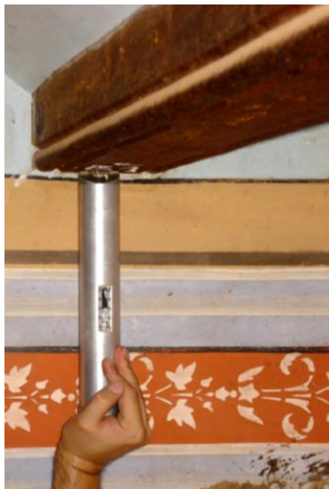
Figura 52. Empleo del penetrómetro en una viga. Fuente: Palaia (2014).
