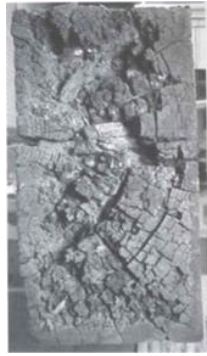
Figura 31. Viga con extensa degradación en el extremo. Fuente: Emerson et al. (2002).
