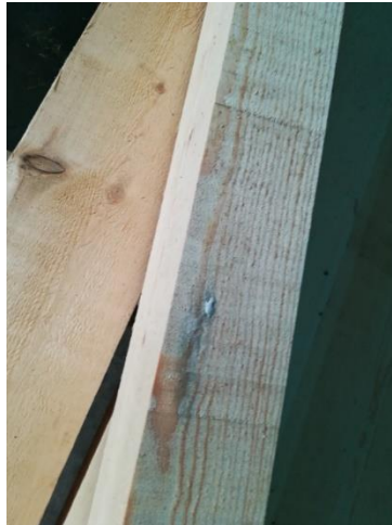
Figura 3. Hongos cromógenos en viga de pino laricio. Fuente: Elaboración propia.
