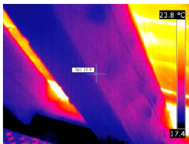
Figura 67. Termograma de la vista del par con deterioro superficial por pudrición parda. Fuente: Rodríguez-Liñan et al. (2011).
