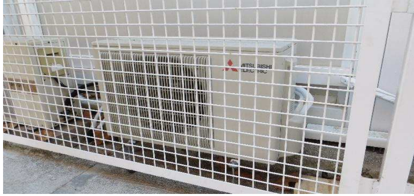
Imagen 16. Edificios con producción propia mediante equipos VRV
