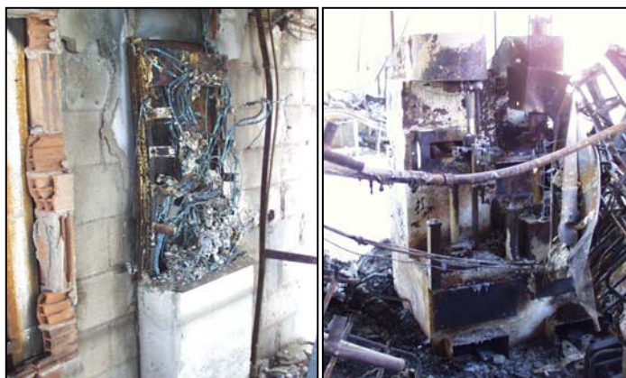
Fig 96. Aspecto que presentaban los cuadros eléctricos después del incendio.
