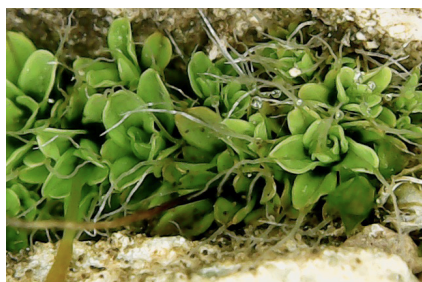
Figura 42. Macrofotografía donde se aprecia musgo creciendo en el interior de una grieta
