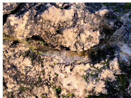
Figura 32. Hielo presente en las grietas del lagar del Salto.
