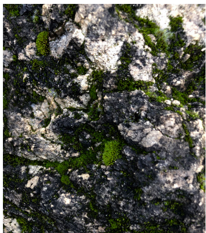
Figura 41. Musgo creciendo en las grietas del sustrato pétreo.
