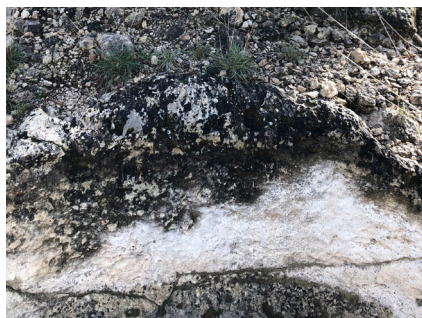
Figura 35. Presencia de pátinas oscuras en la superficie del material pétreo del lagar del Salto.
