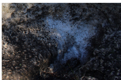
Figura 34. Eflorescencia situada en la plataforma superior del lagar del Salto.
