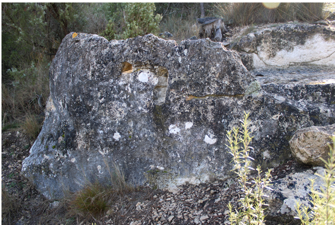
Figura 22. Vista lateral del lagar donde se aprecia su avanzado estado de deterioro, donde se aprecia cómo se superponen líquenes, musgos y tinciones más oscuras en el material pétreo, además de daños estructurales como diversas grietas y fracturas.
