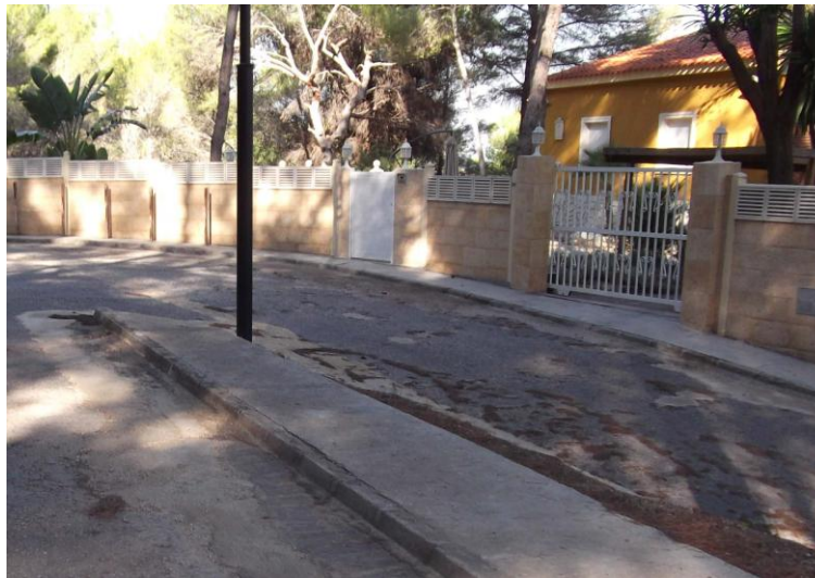
Imagen 30. Ejemplo de estado del asfalto de las calles en Sant Bernat.
