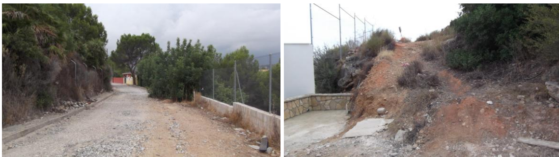
Imagen 37. Estado calle Marina Baixa en su parte final, al lado del depósito.
