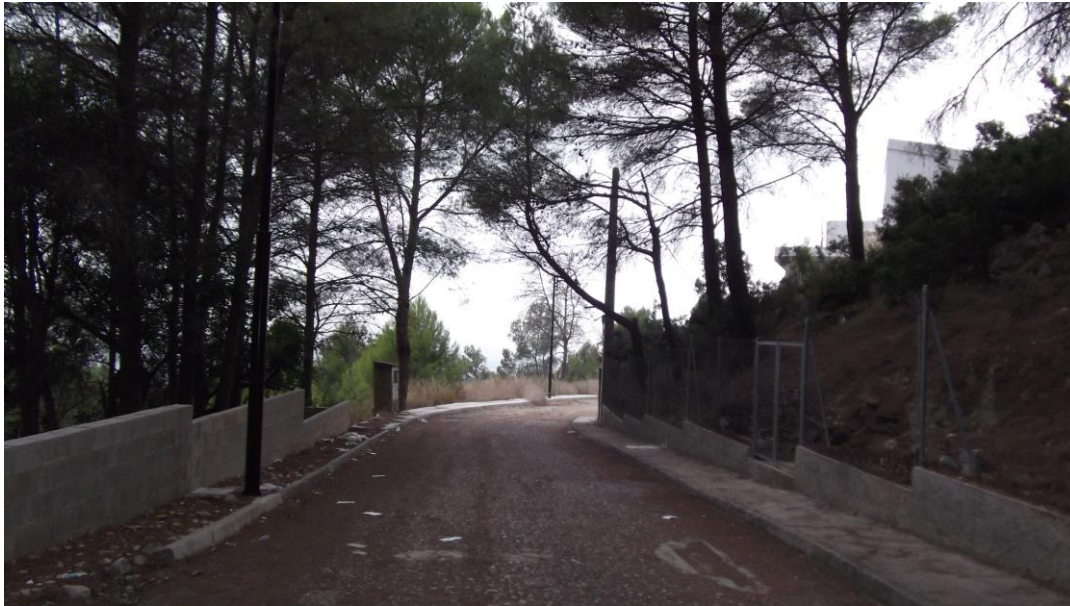
Imagen 38. Estado calle L'Alcoià en su parte final.
