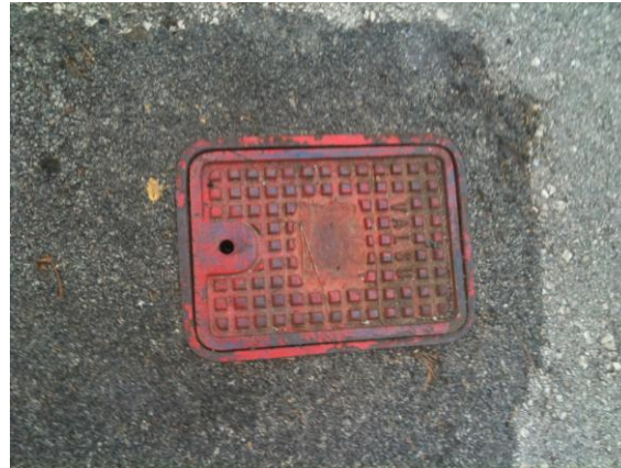
Imagen 41. Ejemplo de boca contra incendios en zona acceso/salida urbanización Sant Bernat.
