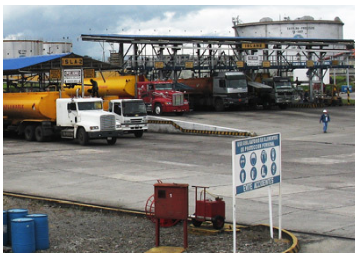
Fotografía N° 4.6 Área Brazos de Carga
