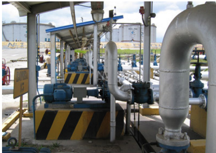
Fotografía N° 4.5 Área de Bombas de Despacho
