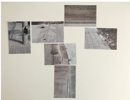
Fig. 7. (Imagen 7) Grietas en el asfalto (Solé, 2019)
