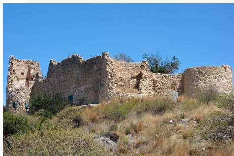
Fig. 1. Vista actual del estado de deterioro de algunos de los lienzos de la fortaleza.
