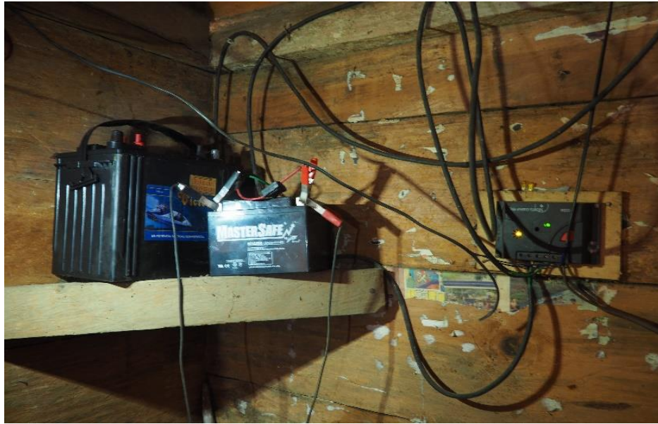
Figura 24: Batería y controlador de carga vivienda 2. Fuente: elaboración propia (2019)
