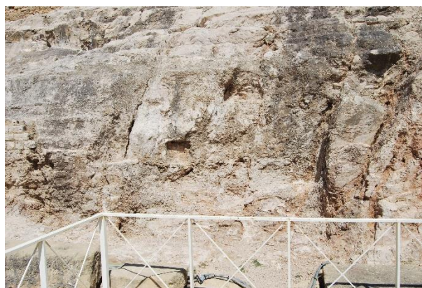
Figura 11: Fotografía del estado actual del santuario a nivel de arena del anfiteatro de Tarraco.
