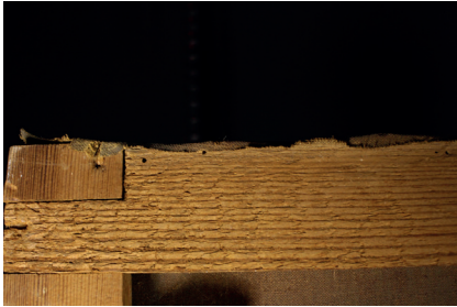
Figura 42: Zona de astillamiento de la madera
