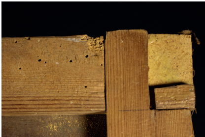
Figura 43: Esquina superior derecha del bastidor con pérdida de soporte
