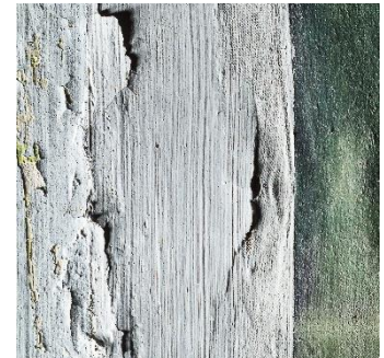
Fig. 141. Grieta de tela San Agustín.
