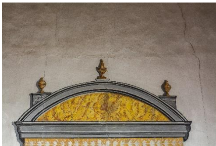
Fig. 116. Grietas del edificio.
