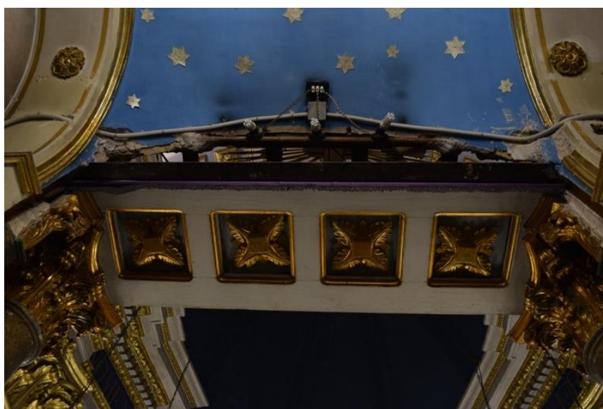
Figura 55.- Instalación eléctrica encima del conjunto escultórico.
