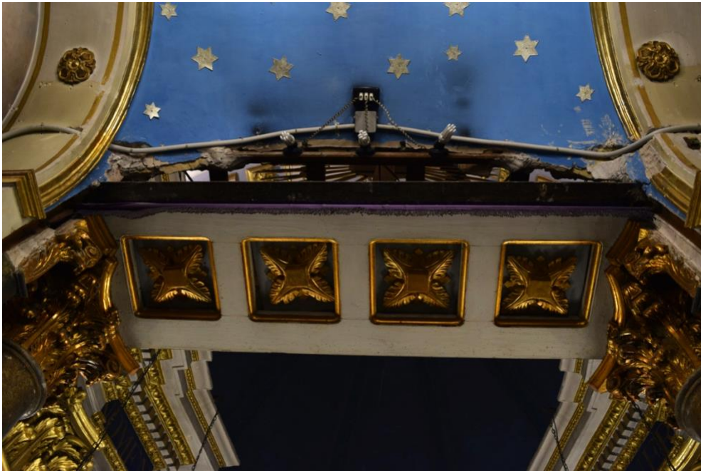
Antes: Instalación Eléctrica
