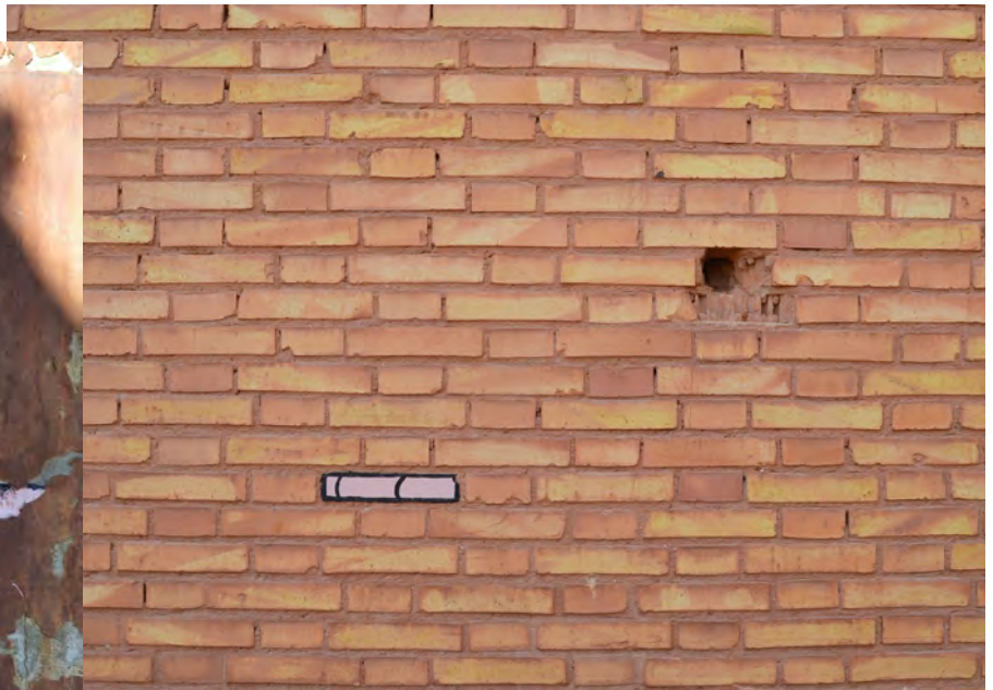
Fig. 135. Unión 1. Cola de rata. Acrílico sobre ladrillo.
