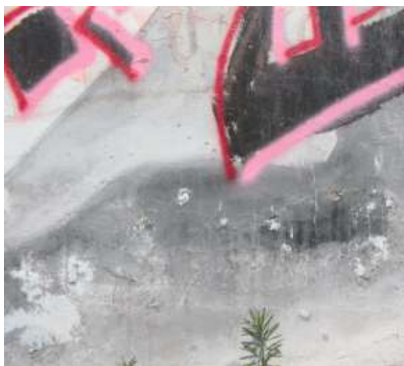
Fig. 51. Detalle de daños.
