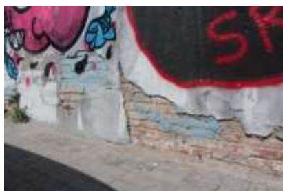
Fig.43. Detalle de pérdida de mortero en la zona central del muro.
