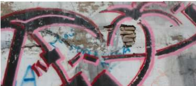
Fig. 48. Grieta estructural horizontal.
