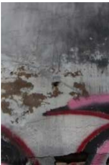
Fig. 50. Daños producidos por la filtración y capilaridad del agua.
