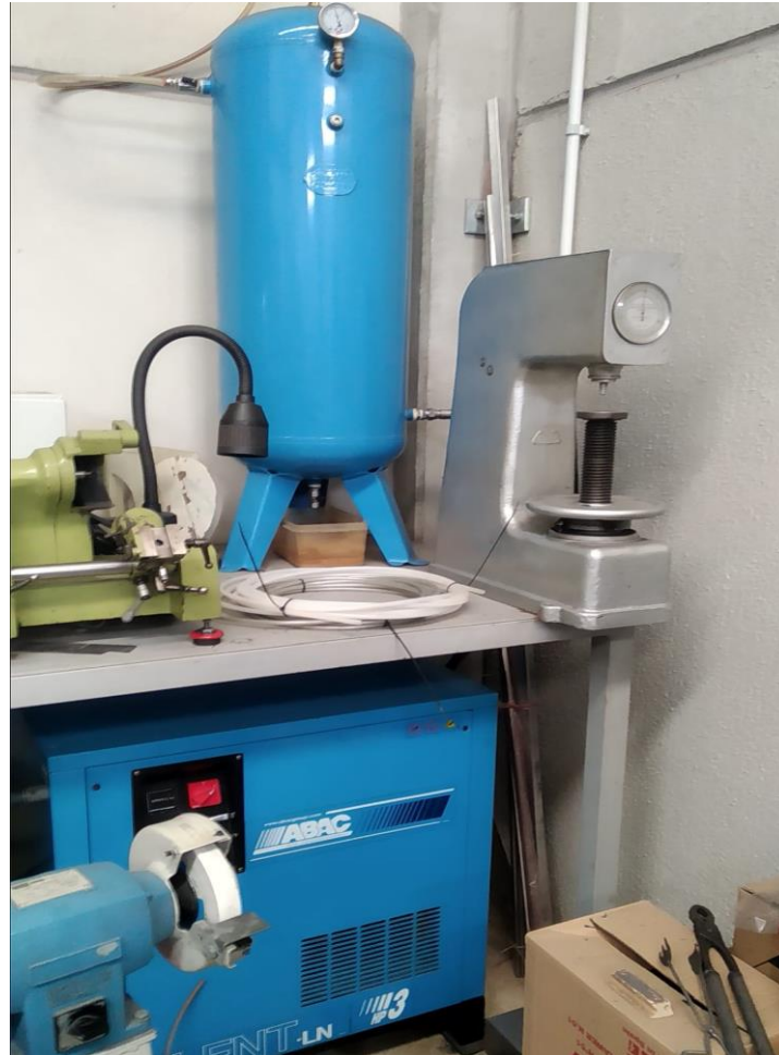
Figura 3.2 Compresor ABAC 3cv
