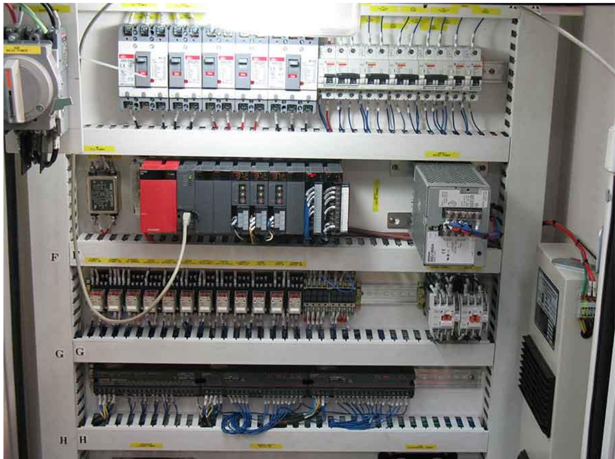
Figura 2.4 Ejemplo de un autómata industrial instalado
