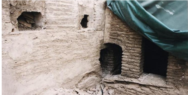
Figura IV.113. Tabiquillo de la cubierta a un agua, en el que se aprecian los huecos de paso de una crujía a otra.
