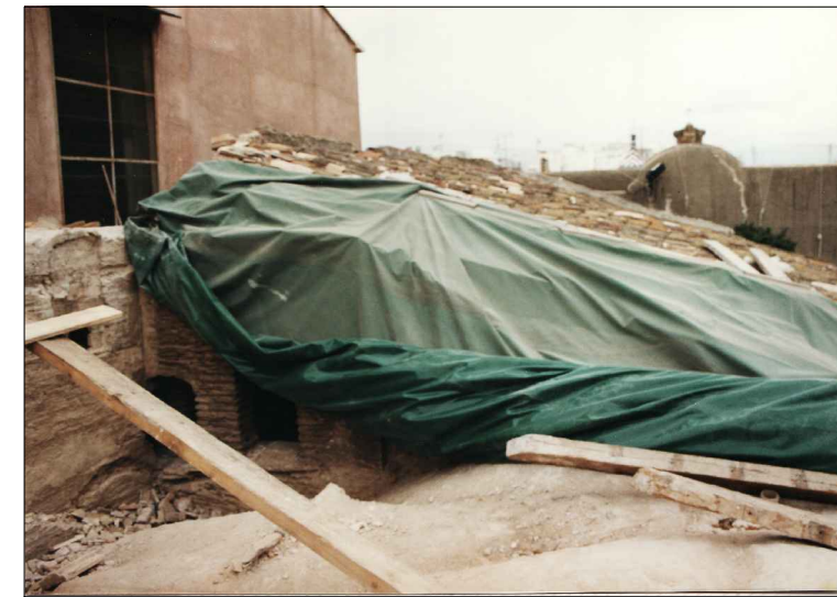
Estado de la cubierta del siglo XVI, a un agua, durante la intervención de 2001 (3)
