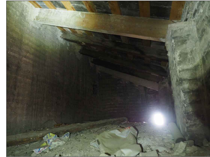
Espacio residual en la zona alta (1)
