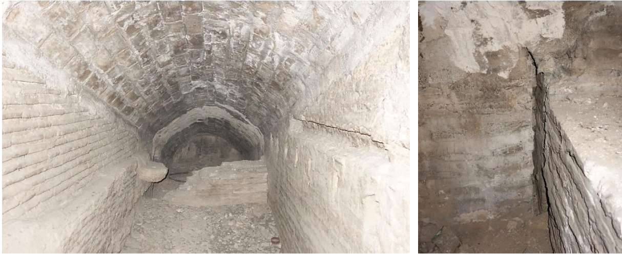
Figura IV.66. Galería bajocubierta del lado de la epístola donde al fondo, junto a la fachada, puede observarse la zona que debió ocupar parte del campanario del siglo XIII (izq.). Falta de traba entre fábricas con diferente técnica constructiva, localizada en el último vano de la galería bajocubierta; la parte derecha de la fotografía corresponde al muro del siglo XIV–XV de la fase 2 de construcción, y la parte izquierda pertenece al muro que reconstruyó el vacío que dejó el derribo del primitivo campanario en el siglo XVI, fase 3 (der.).
