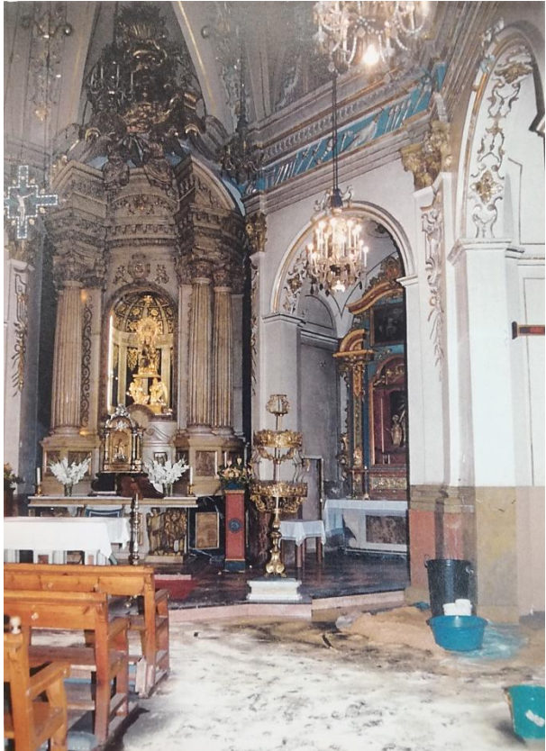
Figura III.14. Desperfectos en el ábside de la Capilla de la Comunión por filtraciones desde cubierta.
