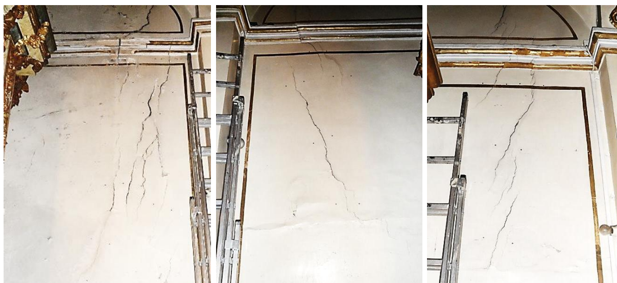
Figura V.41. Grieta 1 (izq.). Grieta 2 (centro). Grieta 3 (der.).
