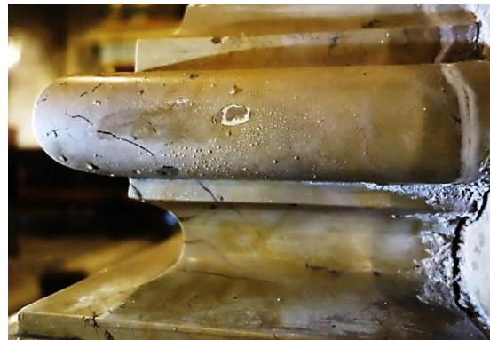
Figura V.26. Coronación de zócalo, en la cual se vislumbran las gotas de agua exudada.
