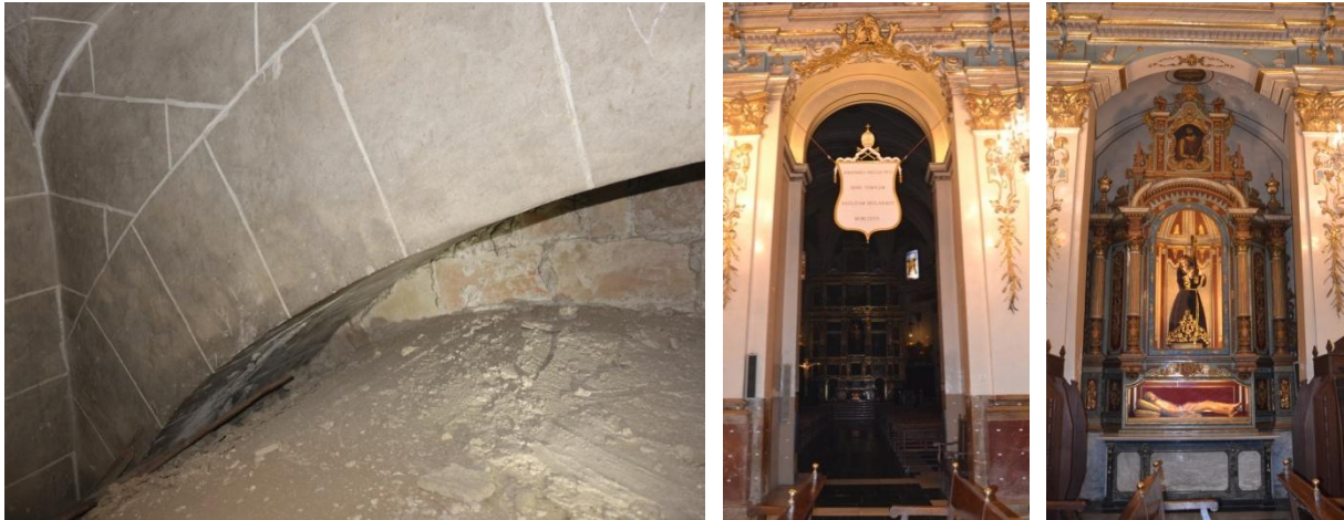
Figura IV.128. Encuentro entre el arco formero del siglo XIV-XV y la bóveda de cañón tabicada del siglo XVIII; al fondo el tabique a panderete que da forma al entablamento (izq.). Vano central de conexión entre la Capilla de la Comunión y la basílica (centro). Capilla central del flanco izquierdo (der.).
