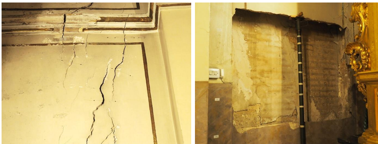
Figura I.11. Grietas que se perciben en uno de los muros divisorios entre capillas laterales (izq.). Mismo muro, visto desde la capilla contigua —la primera absidal del flanco izquierdo—, cuyo colapso ha dejado al descubierto el estribo original (der.).
