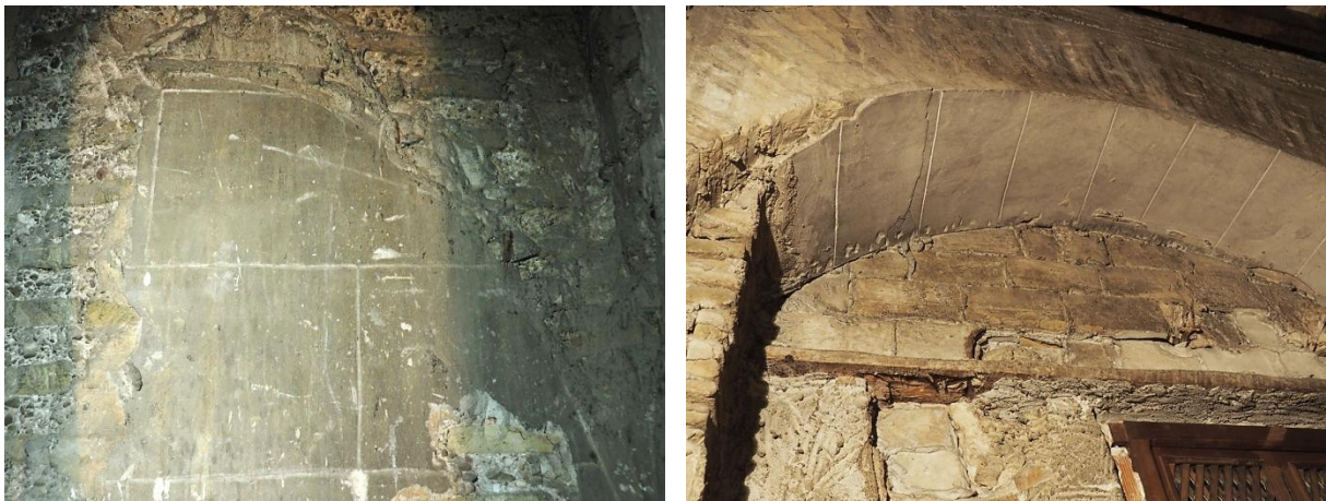
Figura IV.116. Pinceladura en el altar de la Mare de Déu de la Salut (izq.). Pinceladura localizada en una estancia del último tramo de la basílica (der.).
