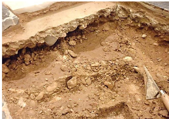
Figura VI.4. Estrato húmedo en contacto con el hormigón de regularización.
