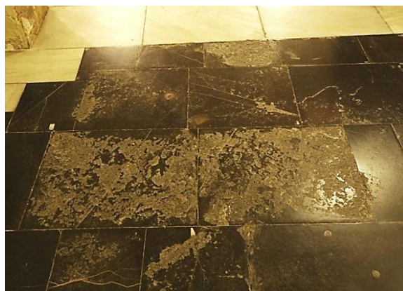
Figura I.6. Exfoliaci3n del pavimento marm3reo.
