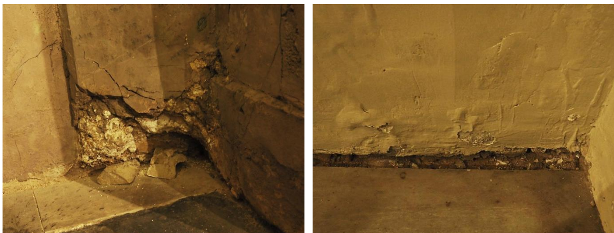
Figura V.23. Puntos de mayor evaporación en ábside; vaciado de material en la capilla absidial del flanco izquierdo (izq.), y vaciado de junta en el espacio absidial que sirve de nexo entre iglesias (der.).
