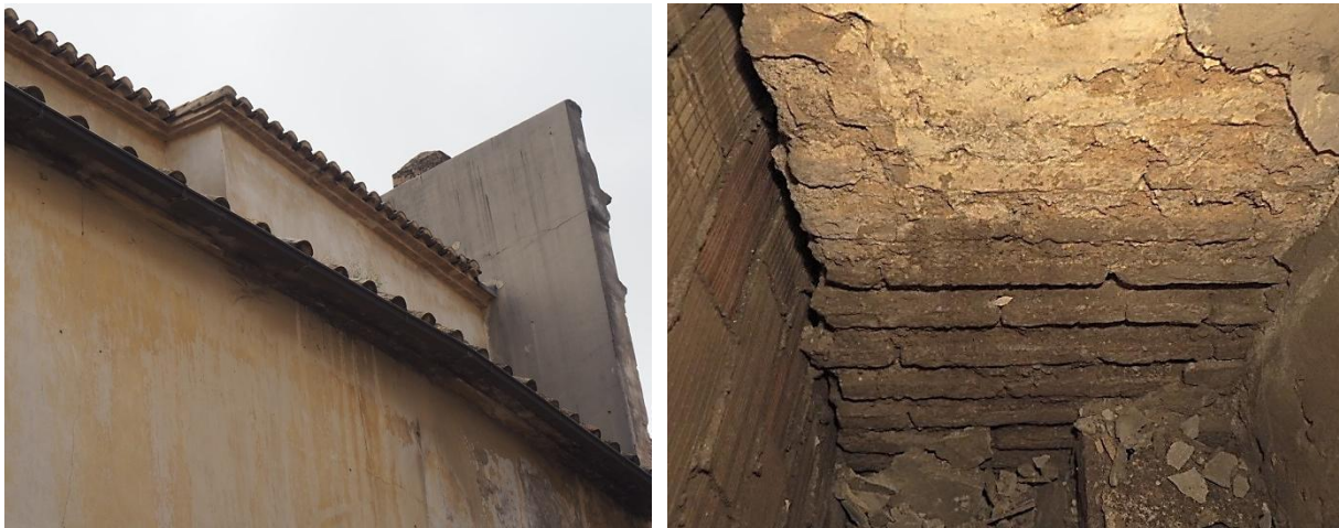
Figura IV.67. Muro del siglo XIV–XV —visiblemente de mayor espesor— del cual, actualmente, aún se conserva su trazado externo pese a haberse realizado una intervención en la cubierta en 2001 (izq.). Restos del ancho muro correspondiente a la fase 2, que han sido preservados en el espacio comprendido entre el muro de fachada y el revestimiento interior de la iglesia realizado en el siglo XVIII–XIX, fase 5 (der.).
