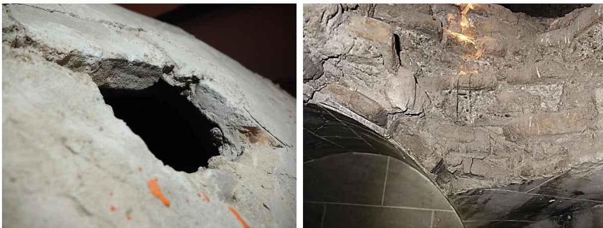
Figura IV.103. Sección plementería bóveda de crucería, sita en la primera crujía de la nave principal (izq.). Sección bóveda de arista, sita en la capilla central del lateral derecho (der.).
