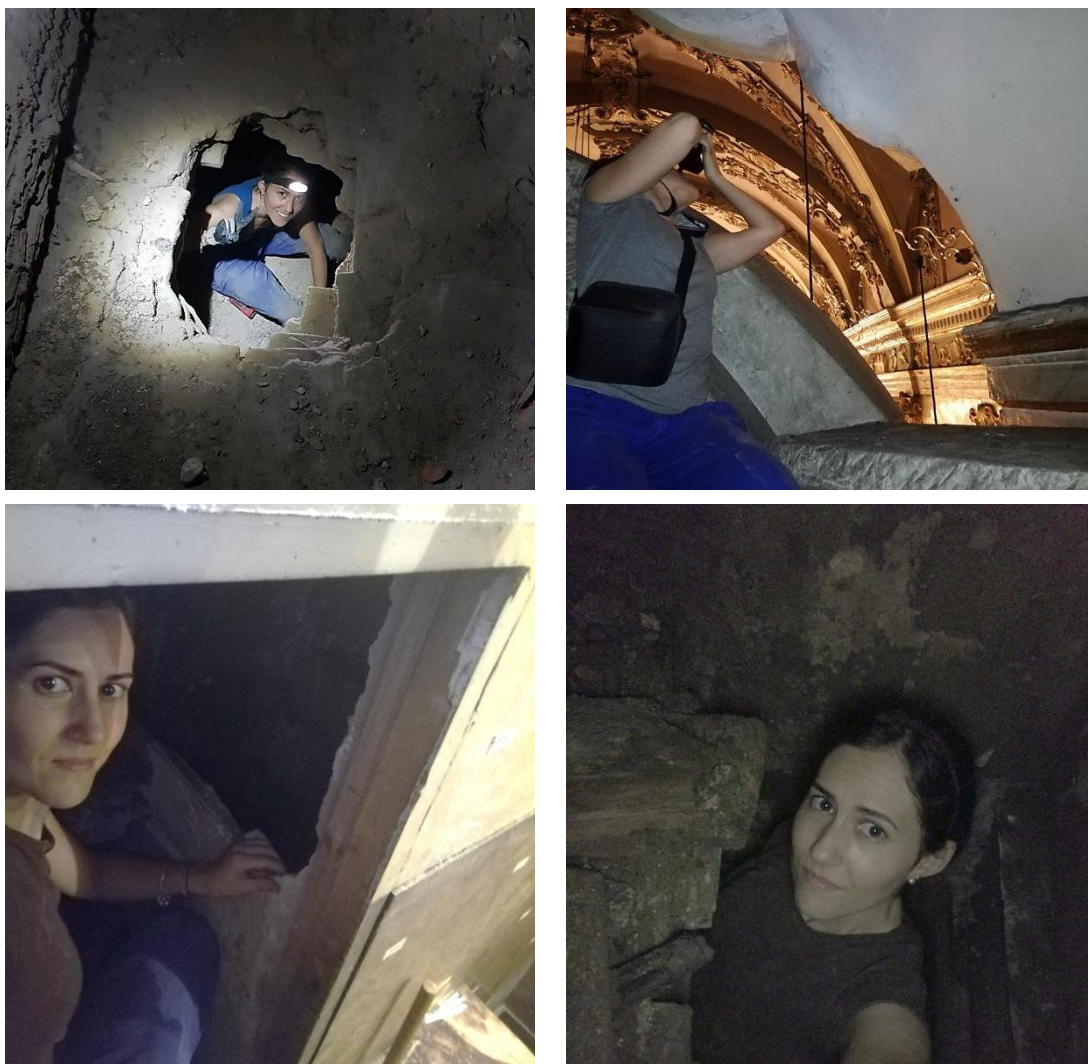
Figura I.15. Rotura de la plementería, localizada en el flanco derecho, que da acceso al espacio entre bóvedas laterales (sup. izq.). Parte alta del altar principal (sup. der.). Cata practicada en una alacena sita en la capilla contigua a la entrada al templo (inf. izq.). Espacio residual, entre la fachada y el revestimiento rococó, accesible desde el hueco abierto en la citada alacena (inf. der.).
