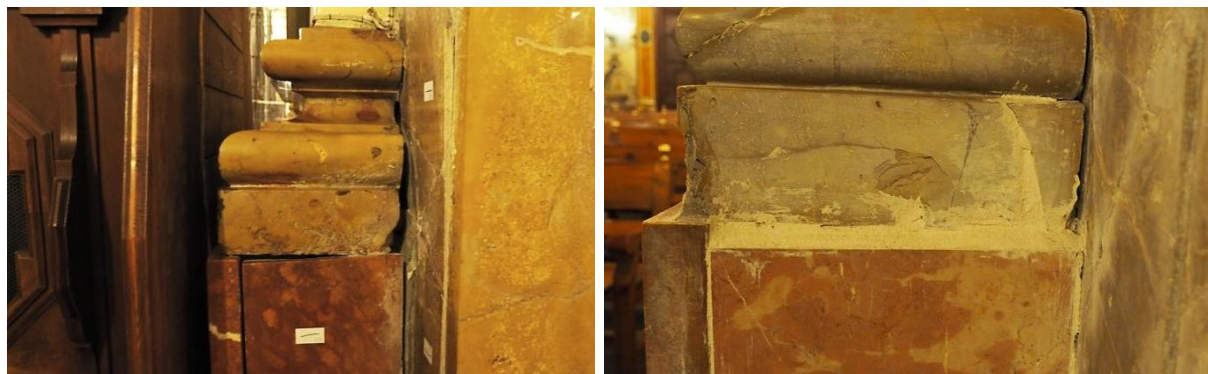
Figura 1.9. Pérdida del mortero de agarre (izq.). Rejuntado del aplacado (der.).
