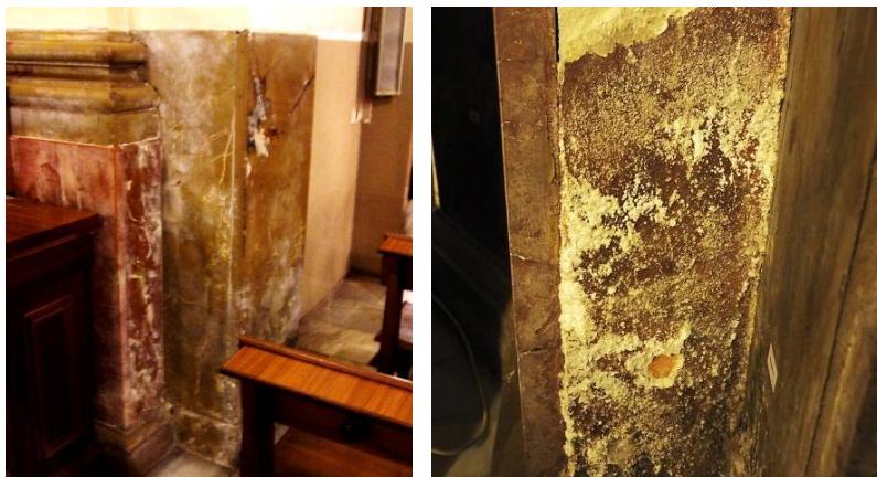
Figura 1.7. Manchas blanquecinas en el zócalo marmóreo (izq.). Depósito salino en el aplacado de la pilastra (der.).
