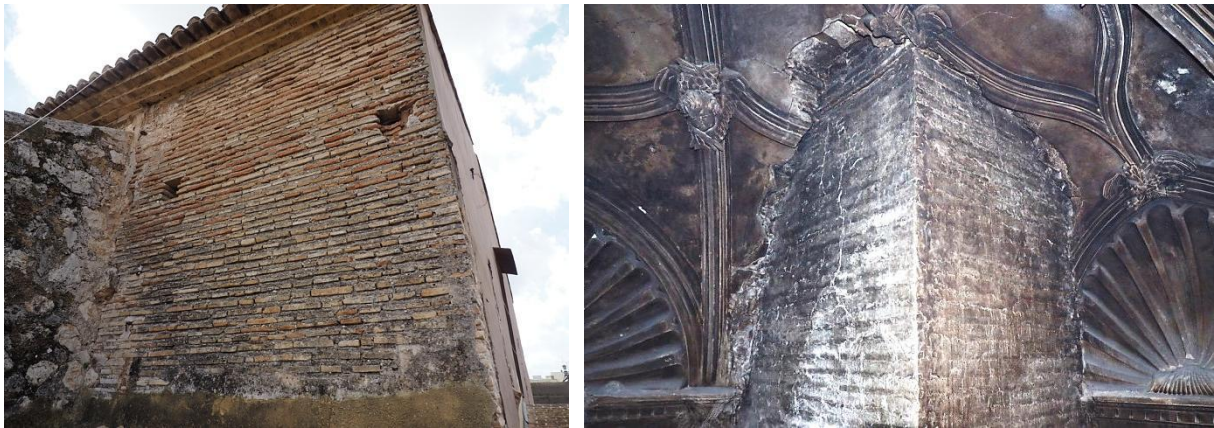
Figura IV.109. Última crujía de la basílica, vista desde la cubierta de la Capilla de la Comunión (izq.). Mismo muro del último tramo de la basílica, visto desde el interior de la capilla absidial, en donde se aprecia la interrelación entre la bóveda preexistente y la nueva fábrica (der.).
