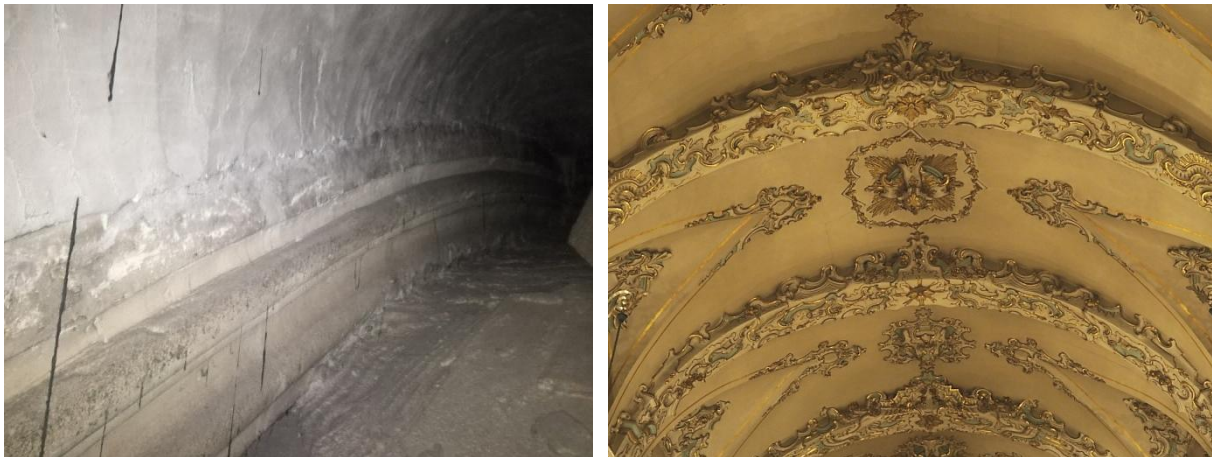
Figura IV.127. Encuentro entre el arco diagonal del siglo XVI y el trasdós de la bóveda del XVIII, correspondiente a la primera crujía (izq.). Bóveda que corona la nave donde se entrevé, en el lateral del arco transversal, la diferencia entre la traza de la preexistencia —siendo esta la directriz del cañón— y el nuevo trazado del arco fajón, más rebajado a medida que se aproxima a la zona central (der.).
