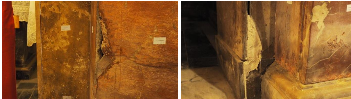
Figura 1.8. Rotura parcial de la losa central del zócalo (izq.). Reposición con mortero en el rodapié (der.).
