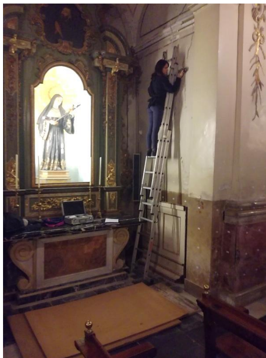
Figura I.17. Control del cuadro fisurativo manifiesto en los muros entre capillas.
