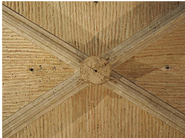
Figura IV.86. Bóveda de crucería con plementería de ladrillo a rosca, sita en la Catedral de Valencia.
