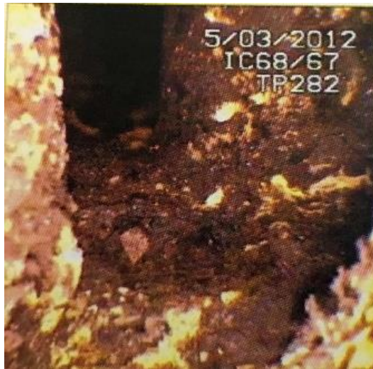
Figura 2-5 Detalle de lodos duros adheridos a la placa de distribución
