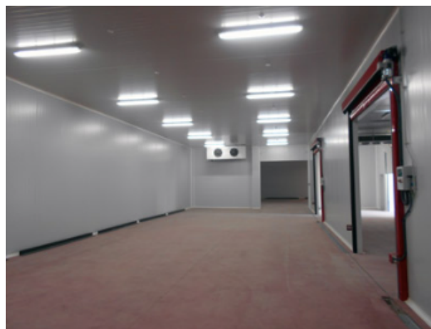
Imagen 8. Cámara frigorífica, fabricante Aiscold.
