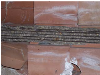
Fig. 1. Viguetas existentes en una edificación con armadura corroída.
