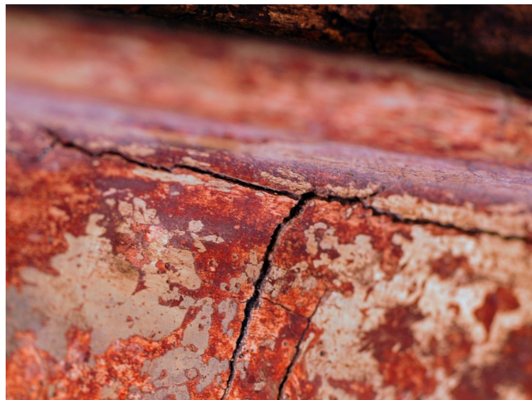
Fig. 20 Patologías encontradas “Grieta”.
