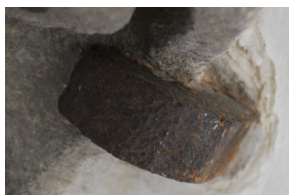
Fig. 22. Elemento metálico N° 3 después de la limpieza a bisturí.
