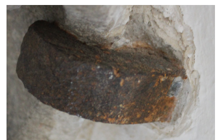
Fig. 23. Elemento metálico N° 3 después de la limpieza a bisturí.
