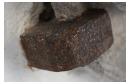
Fig. 20. Elemento metálico N° 2 después de la limpieza a bisturí.
