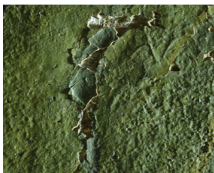
Fig. 44. Detalle en el que se observa un estuco y un repinte, cuarteados y en proceso de desprendimiento.
