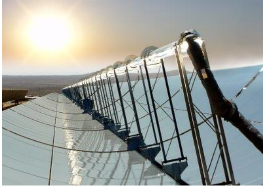
Figura 2.2 Captador solar térmico de cilindros parabólicos. (Solclima.es, 2019)
