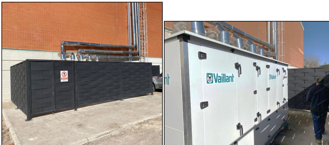
Figuras 27 y 28. calderas de gas natural (Fuente: propia)
