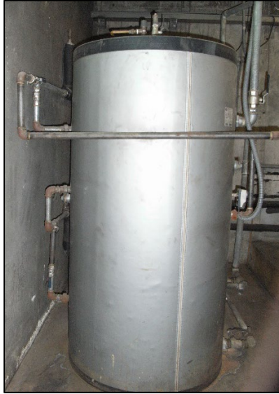
Figura 20. Estado inicial Acumuladores (Fuente: propia)
