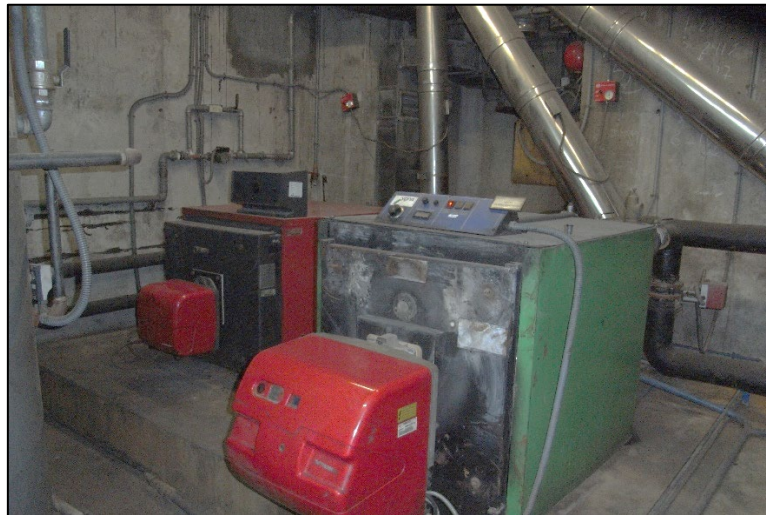
Figura 23. Estado inicial de las calderas (Fuente: propia)
