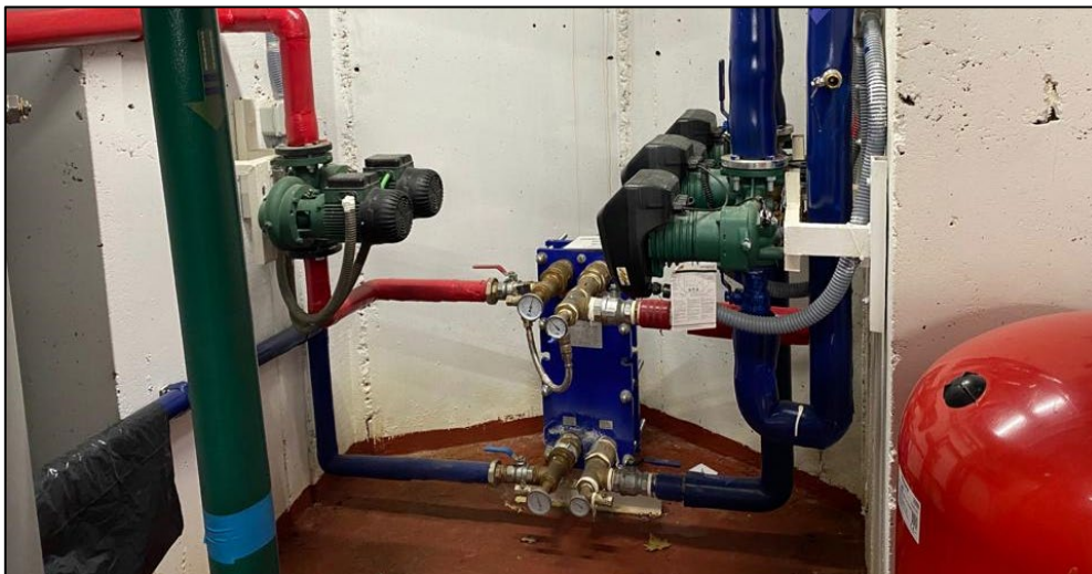
FIGURA 32. Intercambiador de calor solar (Fuente: propia)
