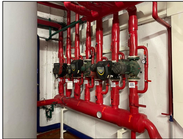
Figura 31. Tuberías y Bombas sala de calderas (Fuente: propia)
