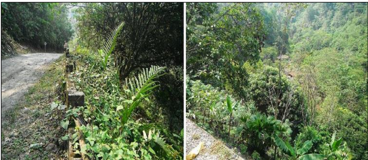
Figura 4. Talud inferior con elevada vegetación
