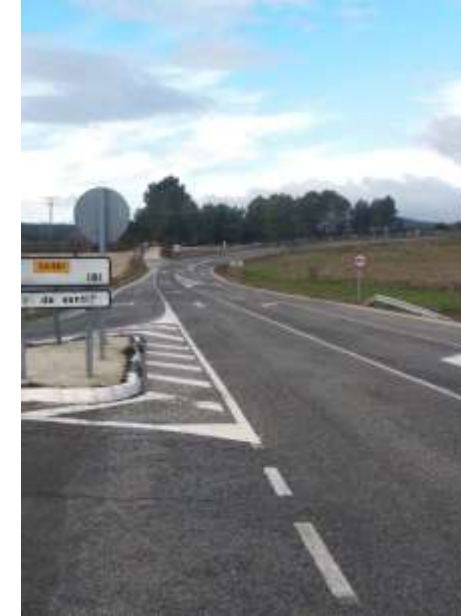
Figura 5: Estado del firme en el entorno de la intersección n°8.
