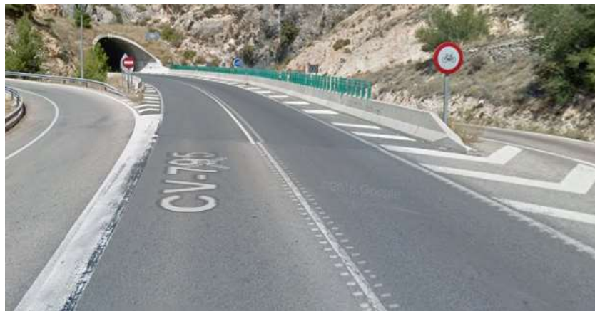
Figura 4: Estado del firme en el entorno del Túnel del Salt. Fuente: Google Earth
