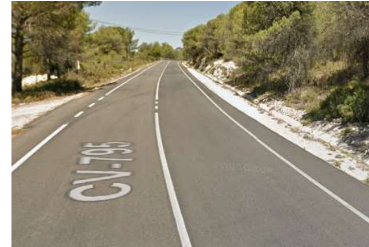
Figura 8: Estado de las marcas viales. Fuente: Google Earth
