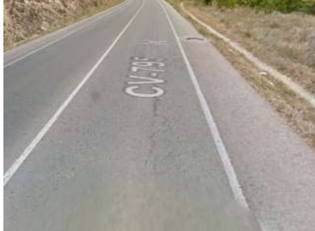
Figura 3 Estado del firme en el tramo inicial del tramo en estudio. Fuente: Google Earth
