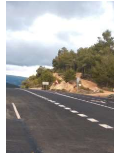
Figura 6: Estado del firme en el entorno de la intersección n°9.
