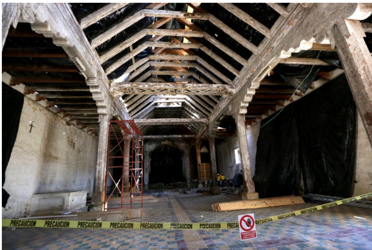
Fig. Anexo 14. Primeras labores de restauración de la iglesia. Interior del inmueble cerrado por obras.
