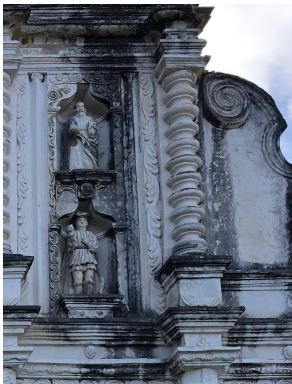
Fig. 9. Fachada principal donde se aprecia la aparición de manchas oscuras ocasionadas por la humedad.
