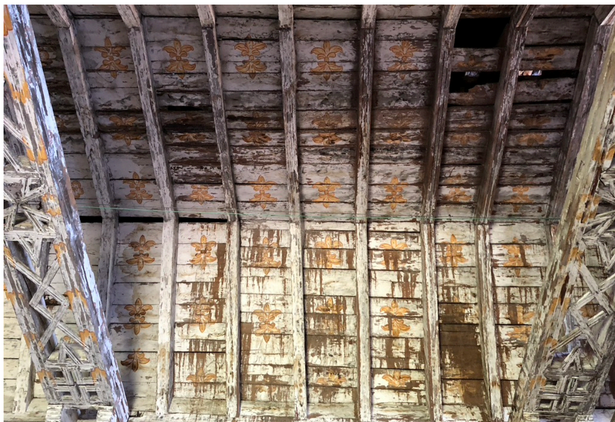
Fig. 18. Escorrentías con pérdida de policromía en el techo de la nave central ocasionadas por la entrada de agua de lluvia.
