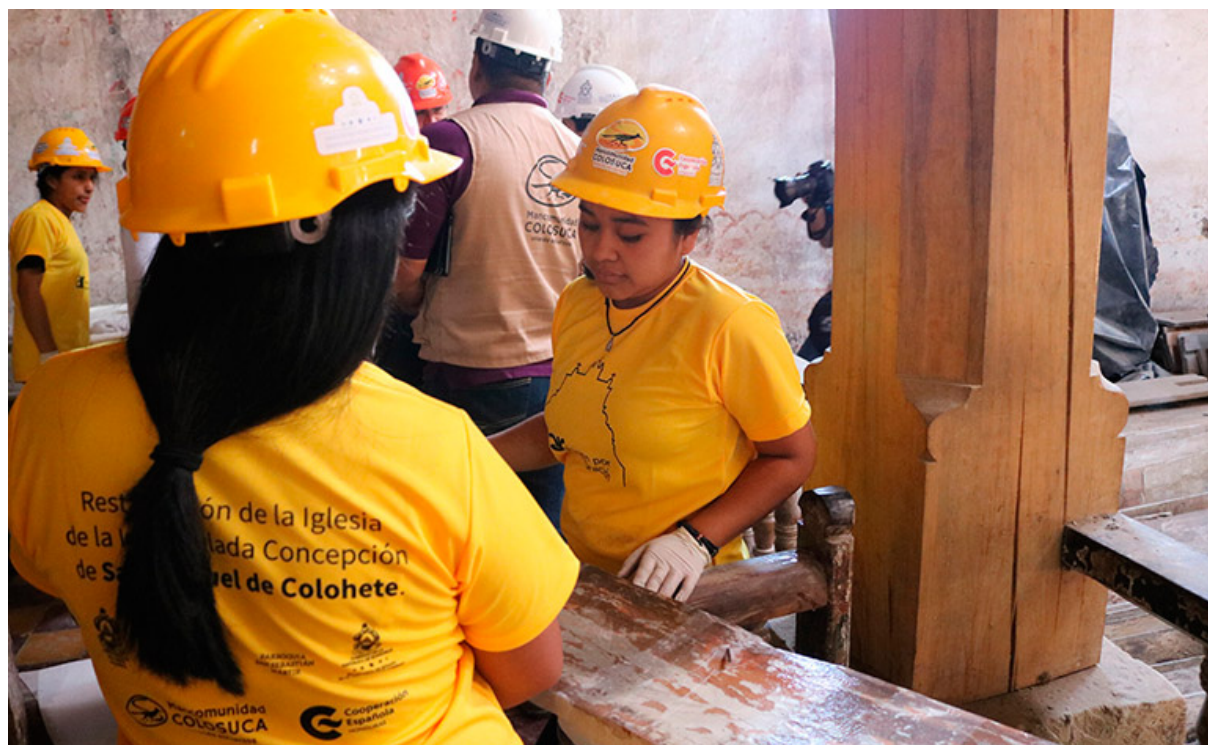
Fig. Anexo 19. Voluntarios de la comunidad en las labores de protección de las tablas policromadas
