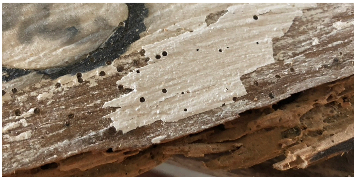
Fig. 22. Biodeterioro causado por el ataque de insectos xilófagos, provocando daños con pérdida del soporte de madera.
