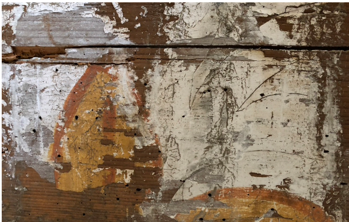
Fig. 17. Descohesión y pérdida de la policromía debido al problema de humedades.
