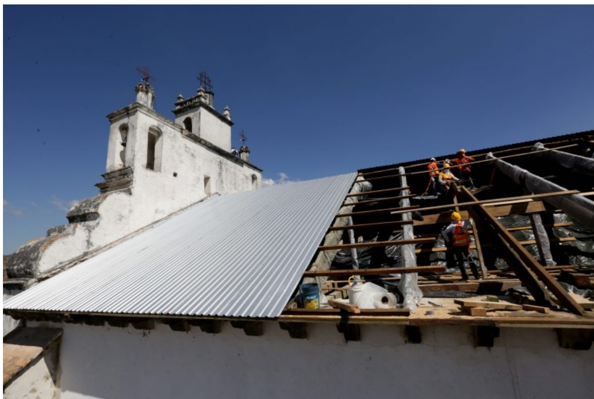
Fig. Anexo 13. Primeras labores de restauración de la iglesia. Trabajos de impermeabilización del techo.
