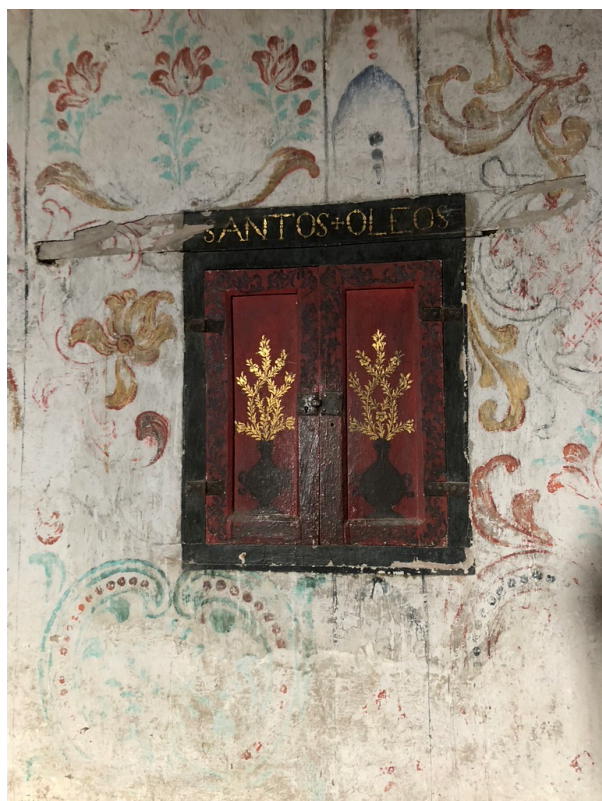
Fig. 11. Armario de los Santos Óleos donde se puede apreciar los daños ocasionados por las humedades en las pinturas murales que lo rodean y la zona baja del muro.
