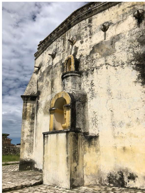
Fig. 10. Fachada este afectada por humedades que han ocasionado la aparición de manchas oscuras.
