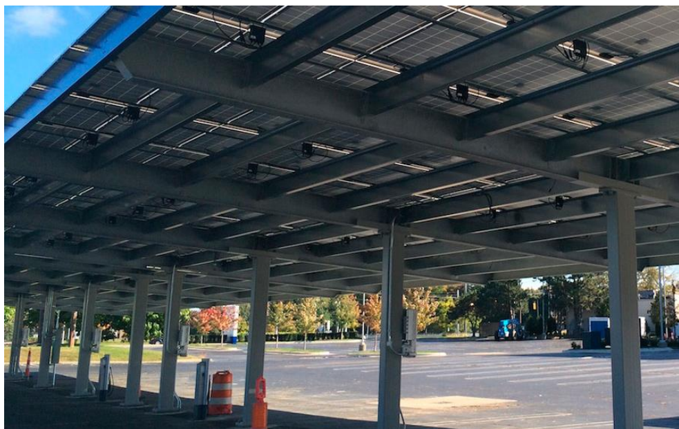
Figura 9: marquesina solar galvanitzada.
