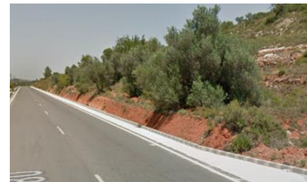
Ilustración 3. Talud situado en el margen derecho de la CV-580 en el P.K. 10+000. (Fuente: Google)
