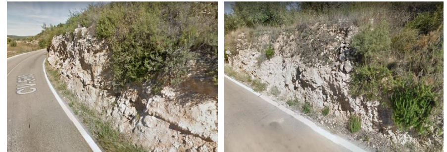
Ilustración 6. Talud situado en el margen derecho de la CV-560 en el P.K. 14+300. (Fuente: Google)
