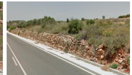
Ilustración 4. Talud situado en el margen derecho de la CV-580 en el P.K. 10+120. (Fuente: Google)
