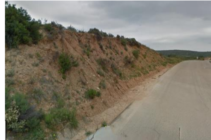
Ilustración 11. Talud situado en el margen izquierdo de uno de los caminos situado al Este de Navarrés accediendo desde la Calle Eras del Alto. (Fuente: Google)
