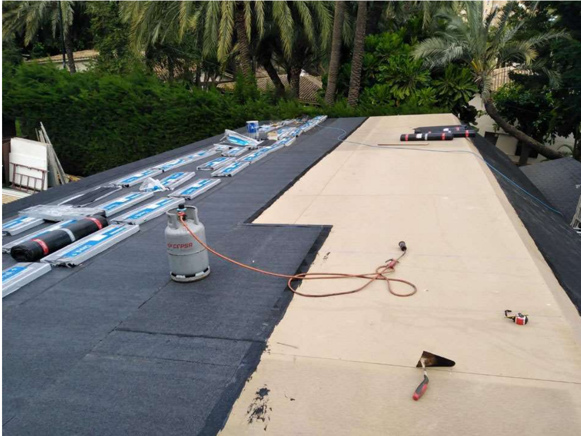
Il·lustració 103: Secuencia de montaje. En proceso de colocación de poliasfal. Imagen de obra.
