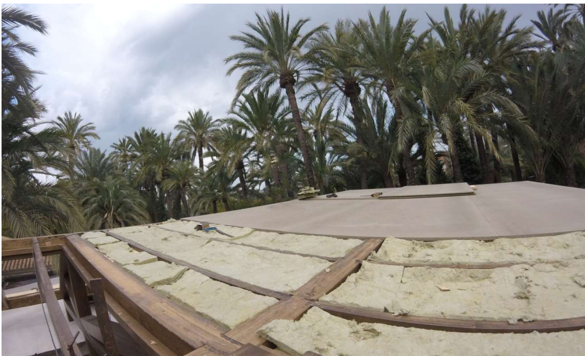
Ilustración 102: Secuencia de montaje. Colocación de aislamiento y tablero aglomerado hidrófugo. Imagen de obra.
