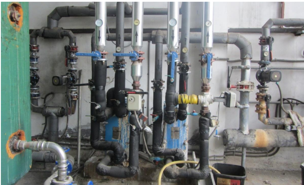
Ilustración 14. Válvulas para distribución de agua
