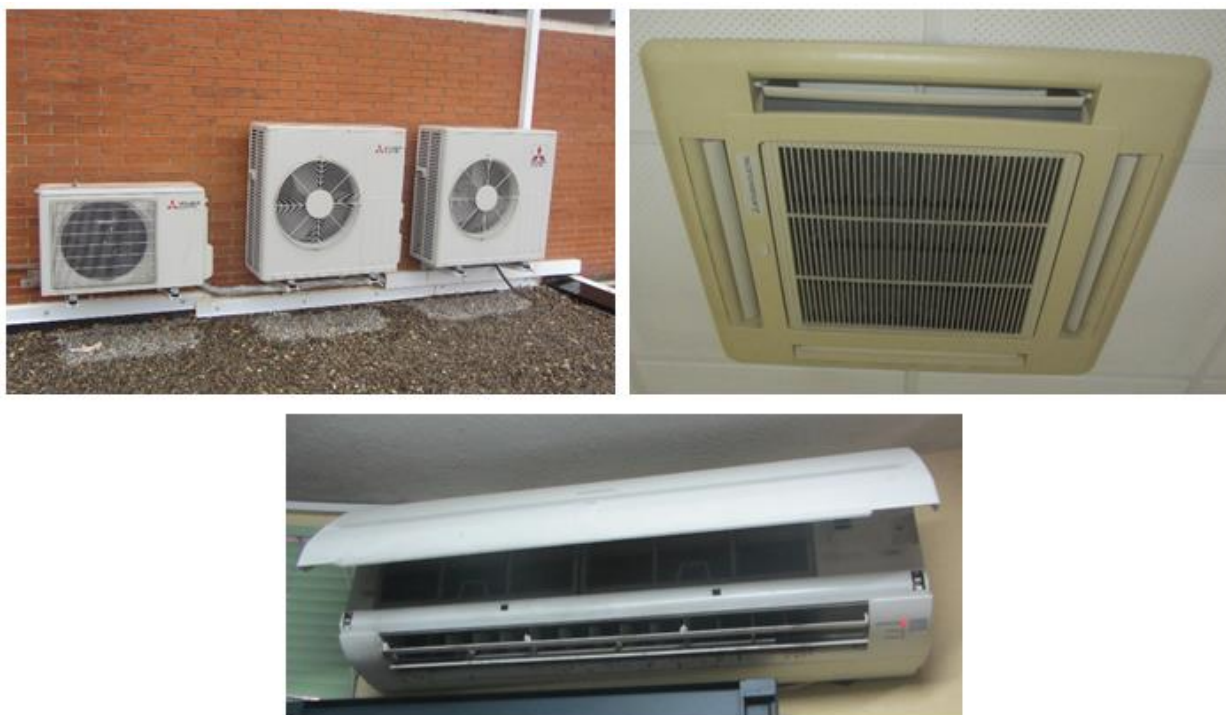
Ilustración 10. Unidades de climatización del Hospital de Requena
