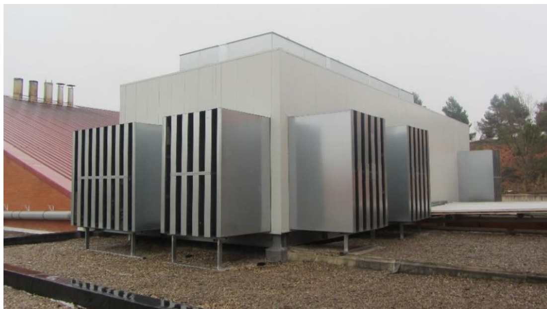
Ilustración 11. Enfriadora del edificio marca McQuay
