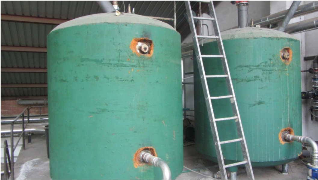
Ilustración 13. Acumuladores de agua
