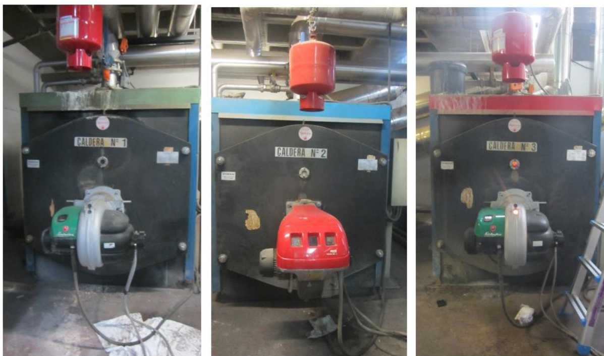
Ilustración 7. Calderas de gasóleo marca Ygnis Ibérica
