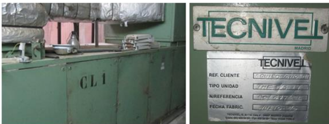
Ilustración 9. Climatizadora marca TECNIVEL
