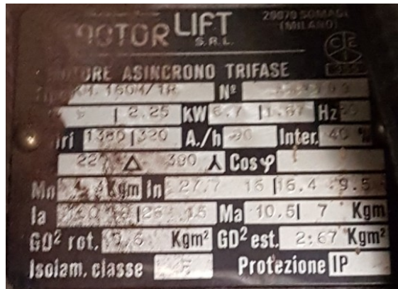
Ilustración 2: Características motor ascensor
