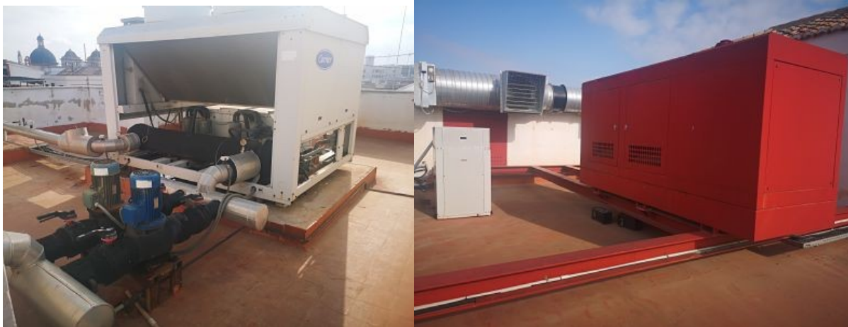
Ilustración 11: Equipos industriales en cubierta.
