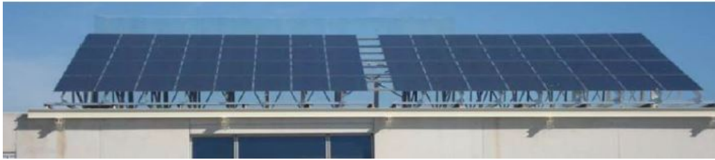
Figura 4.5: Planta fotovoltaica ETSID [35].
