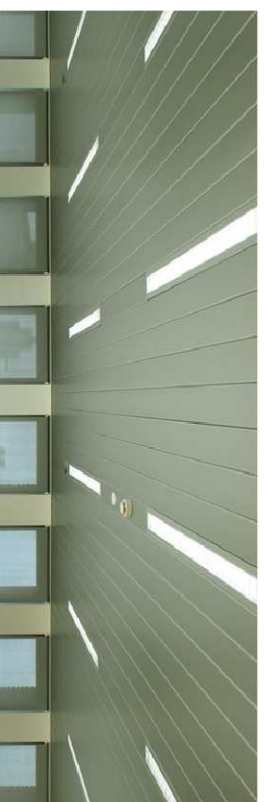
③ Falso techo lineal de bandejas de aluminio para zonas de servicio
