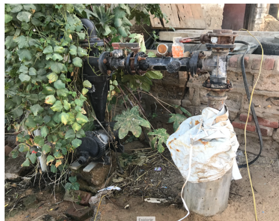
Ilustración 137: Bomba de agua instalada en casa de campo. (Fuente: elaboración propia)
