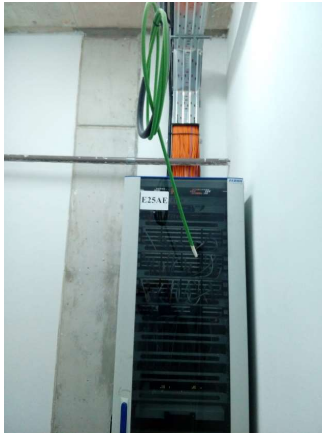
Ilustración 22: Rack ubicado en planta baja
