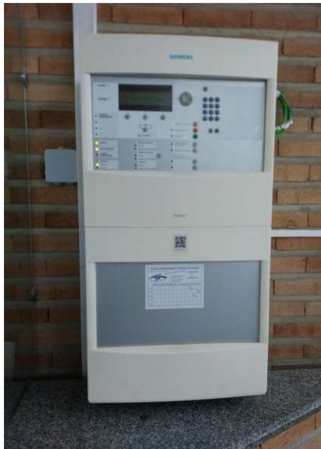
Ilustración 17: Central de incendios FC2060
