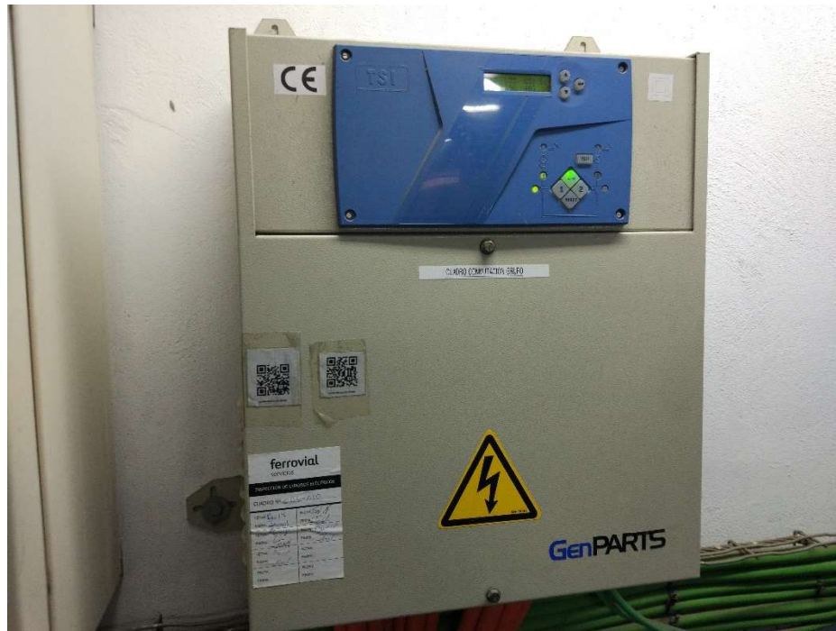
Ilustración 15: Cuadro de conmutación del grupo electrógeno
