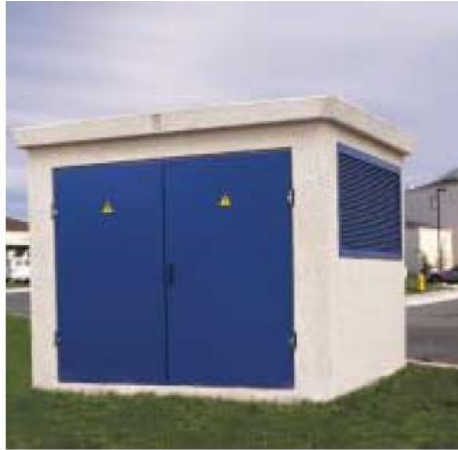
Imagen 5. Centro de Transformación
