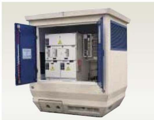
Imagen 6. Centro de Transformación
