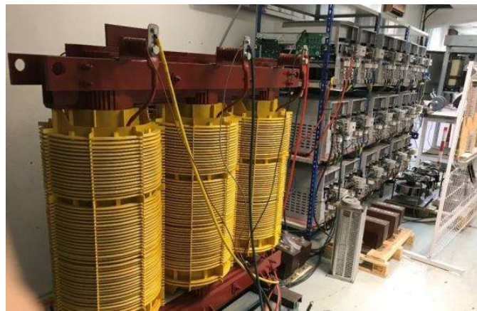
Figura 7.7 Detalle montaje variador de media tensión (transformador).
