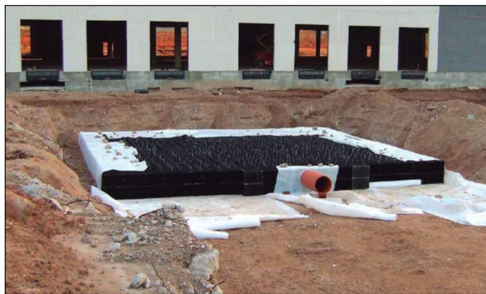
Figura I. 20. Depósito de infiltración.
