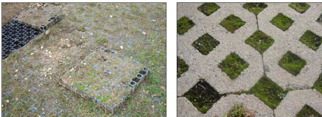
Figura II. 2. Césped con refuerzos de plástico (Izquierda) (Rodríguez Hernández, 2008) y con refuerzos de hormigón (derecha). (Zachary, 2005).
