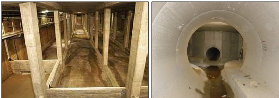
Figura I. 14. Tanque de tormentas en Barcelona (izquierda) y colector de gran diámetro (derecha).
