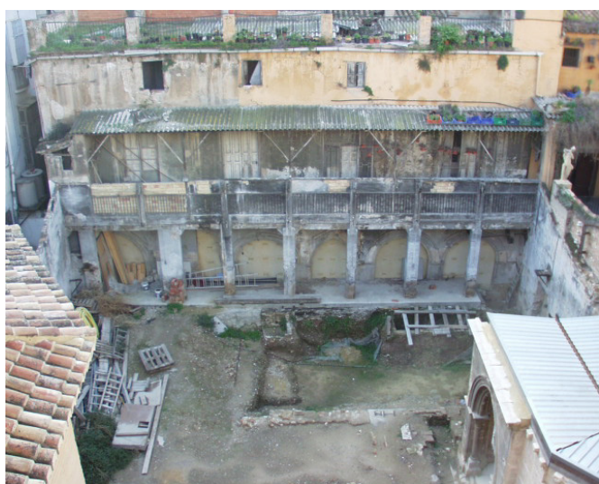
Figura 8. Vista de los arcosolios de la panda sur con los dos pisos de edificación del palacio de Valeriola descansando sobre ellos. Archivo del Museo de San Juan del Hospital.
