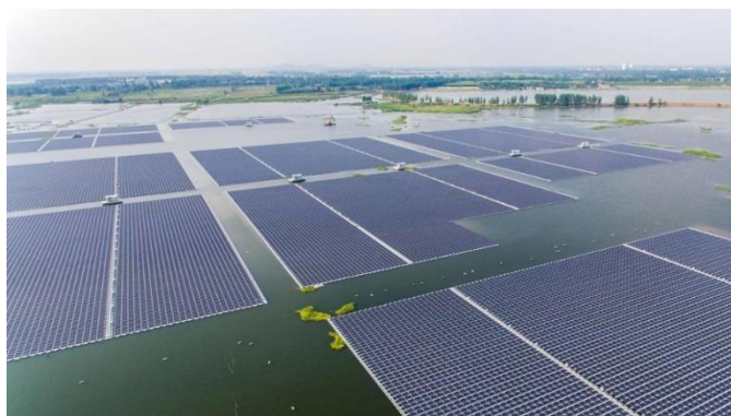
Imatge 1. Major instal·lació de FV flotant del món. Font : La Vanguardia.
