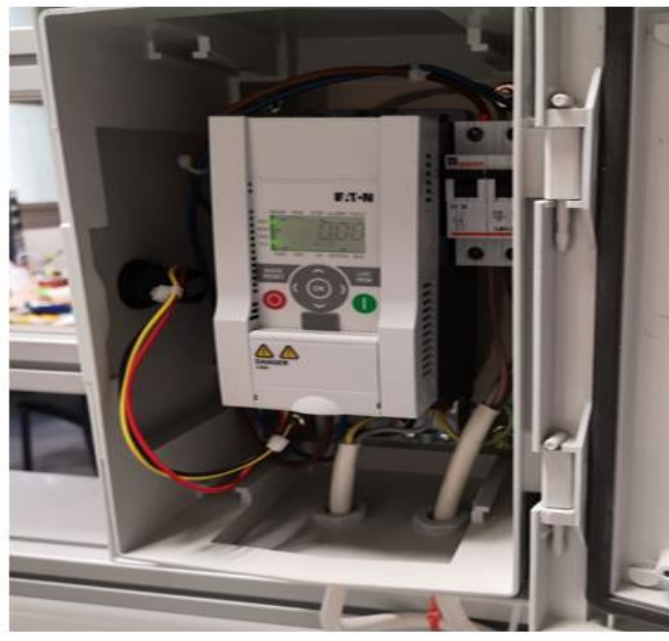
Figura 4.4 Variador de frecuencia de la bomba
