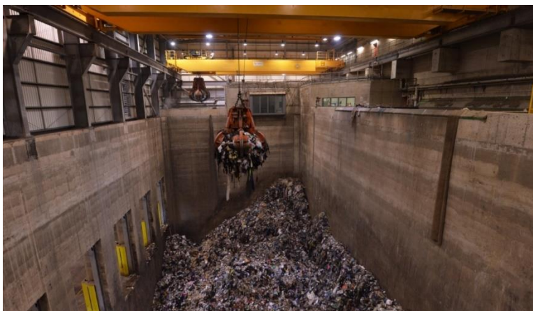
Ilustración 9: Búnker de almacenamiento de RSU
