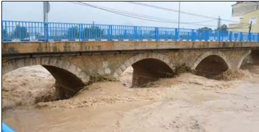
Fotografía 1. Vista 1 de la Crecida en el Puente de Beniarbieg
