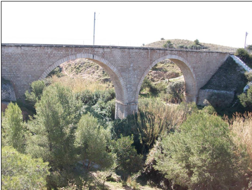
Fotografía 12. Sección del puente sobre el Barranco Torres existente vista desde aguas arriba
