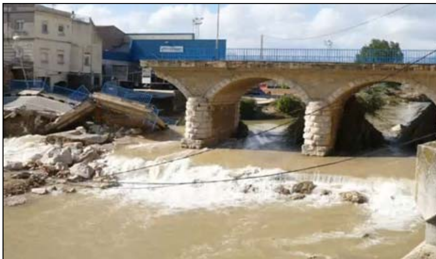
Fotografía 5. Vista 2 de la Crecida en el Puente de Beniariieg hundido
