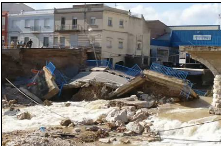
Fotografía 6. Vista 3 de la Crecida en el Puente de Beniariieg hundido
