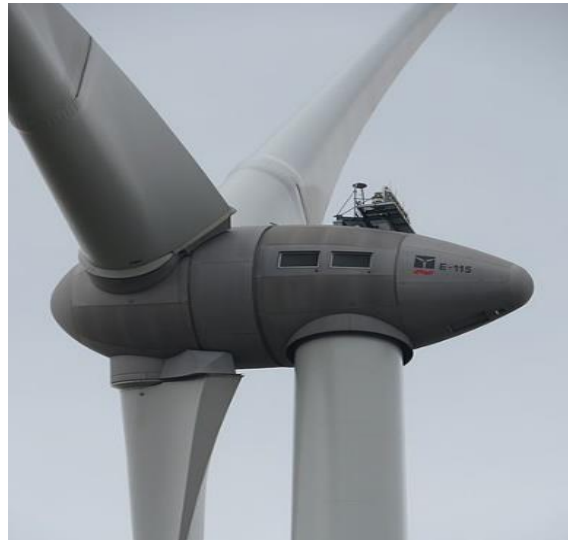
Figura 53. Aerogenerador E-115 (3,00 MW).
