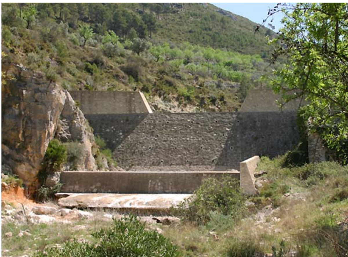
Foto 12. Dique situado a 1,3 Km. aguas abajo del núcleo urbano de Castell de Castells
