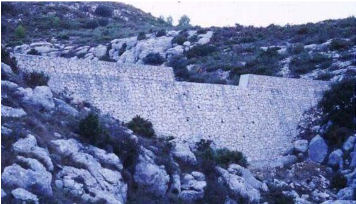
Foto 14. Dique (desde aguas abajo) en el río Castell, en T.M. de Castell de Castells
