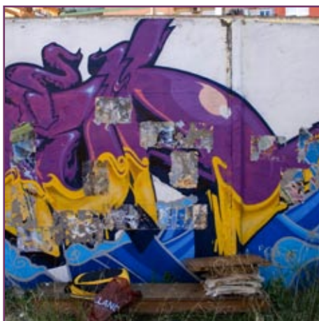
Fig. 34. Detalle, muro tres arranque
