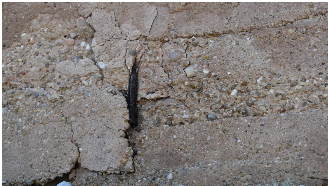
Imagen 54. Lienzo 1 del Tramo Norte, desprendimiento de costra y barra de acero visible. Fuente: Autora.
