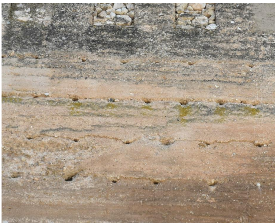
Imagen 104. Detalle del paramento del lienzo 1, donde se aprecia el desarrollo de microorganismos, como moho y hongos, bajo la línea de mechinales de las agujas previamente se ha deteriorado por la presencia de líquenes. Fuente: Autora.
