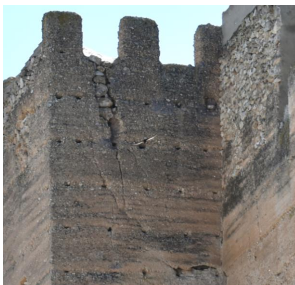
Imagen 106. Detalle de fisuras, grietas y oquedades en el lado lateral torre C. Fuente: Autora.
