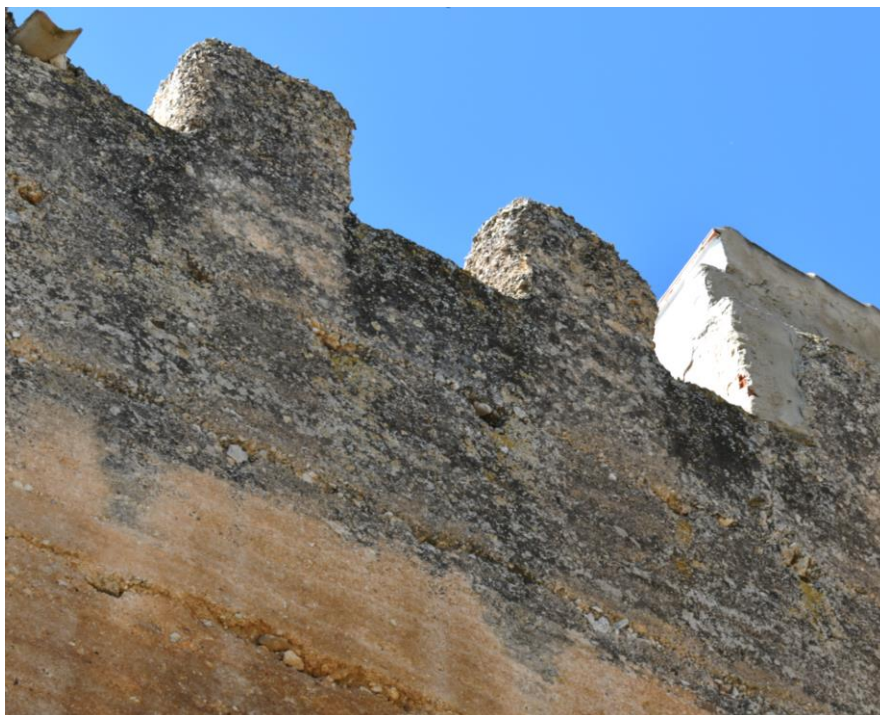
Imagen 103. Detalle de la coronación del lienzo 1. Destaca la coloración grisácea por la presencia de líquenes, en mayor proporción entre almenas debido a la escorrentía de agua de lluvia. Fuente: Autora.
