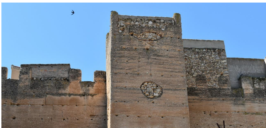
Imagen 51. Saetera de la Torre C en el tramo Norte. Perforaciones en el muro rellenos con mampuesto y elementos añadidos por el crecimiento en altura del cementerio. Fuente: Autora.
