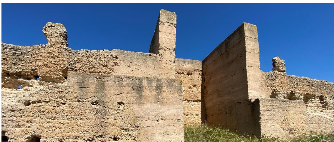
Imagen 67. Detalle 2.1. Cajeados y zunchados coronación torre E, consolidación de almenas existentes. Fuente: Autora.
