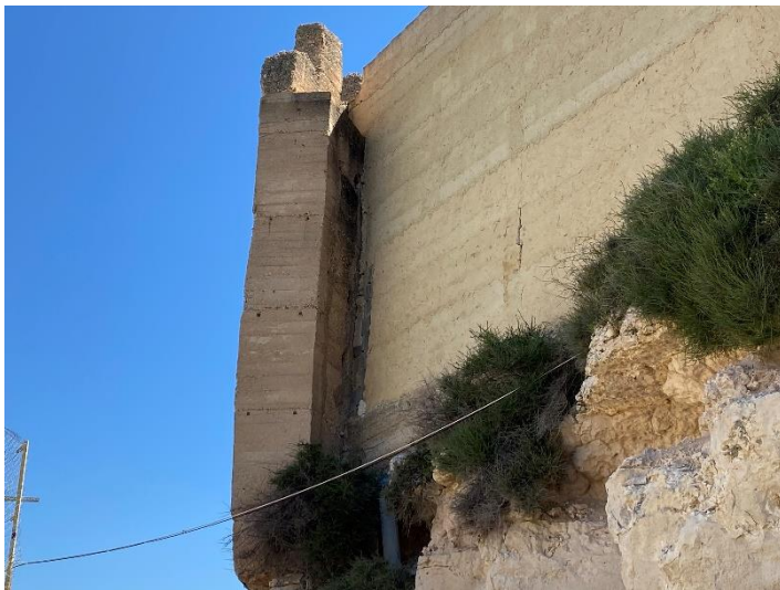
Imagen 18. Unión Lienzo 4 con el muro del cementerio. Fuente: Autora.
