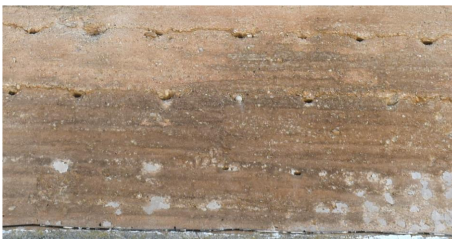
Imagen 100. Detalle de una mancha de humedad en el lienzo 3. Fuente: Autora.
