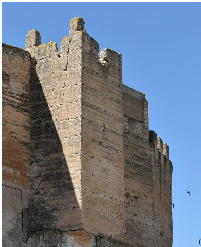
Imagen 109. Torre D, base descalzada y coronación ausente. Fuente: Autora.
