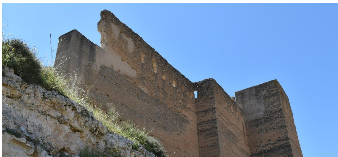
Imagen 68. Detalle 2.2. Rellenado de grietas y saeteras con hormigón de cal, piedra y tierra parda. Fuente: Autora.
