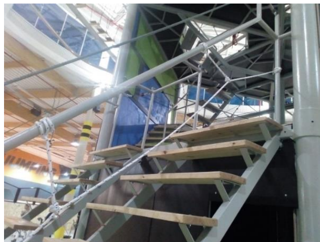
Figura 19. Escalera de acceso (Urban Planet Sagunto). Fuente: Memoria de cálculo de la Torre Multiaventura
